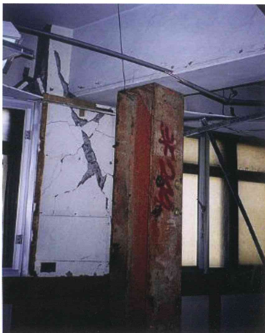
(九) 樑柱接合處破壞 ，樑端45度裂縫
