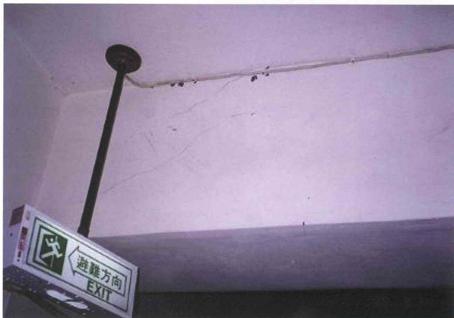
(十) 樑端45度斜裂縫
