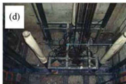
(d) Elevator cable damage (other building)
